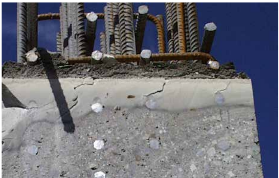
Mynd 2: Dæmi um aðskilnað í steypu [1]
